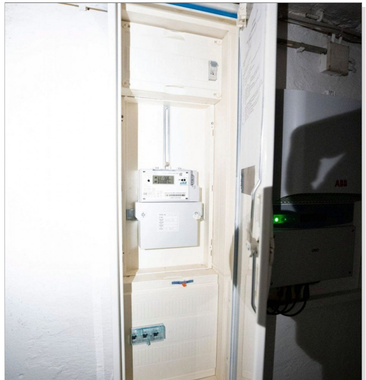
20 KG Zaehlerschrank PV Wechselrichter
